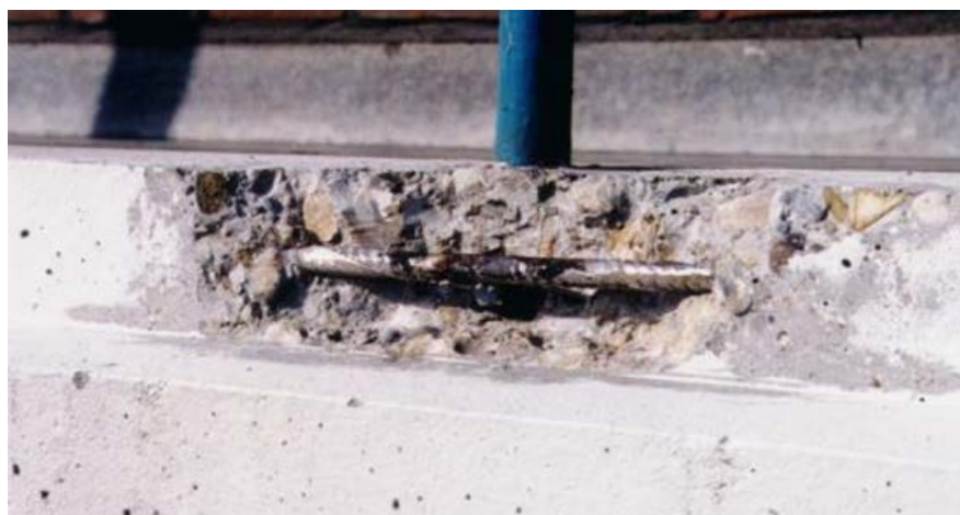
Constructieve schade in een betonnen ondergrond.
